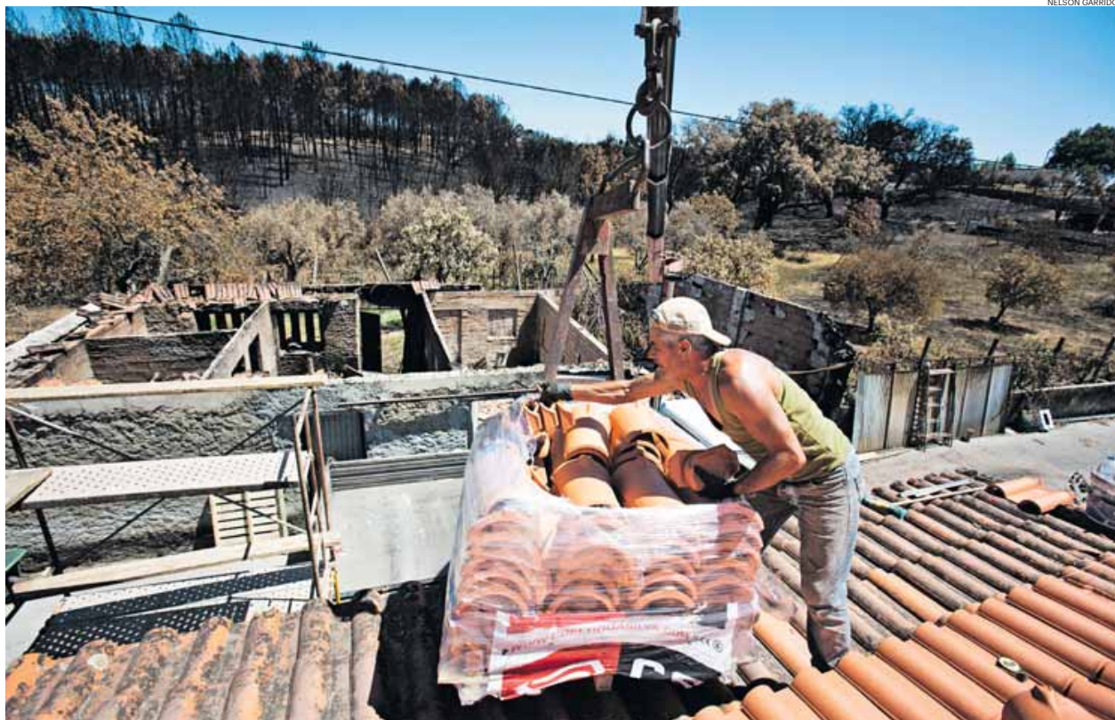
Autoridades identificaram 205 habitações na região que necessitam de reconstrução na sequência dos danos causados pelo incêndio
